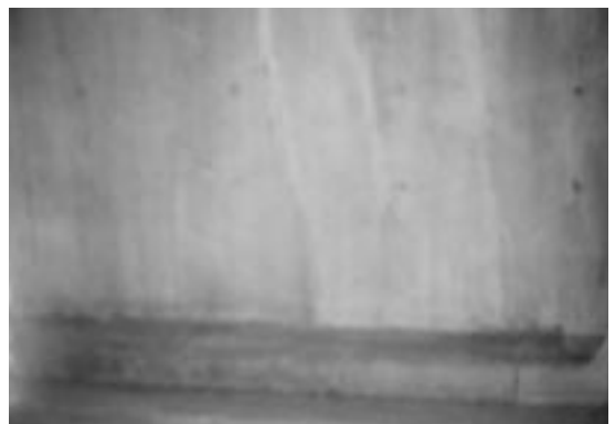
写真1 代表的な汚染部位（公共建築、塀、埼玉県草加市）
