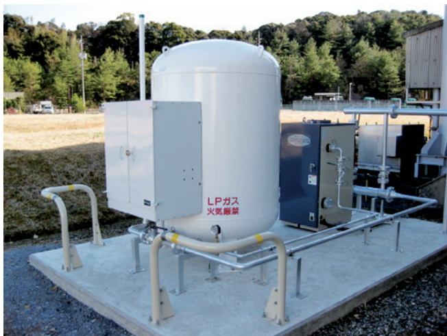
写真4 LPガスバルク貯槽ユニット全景
