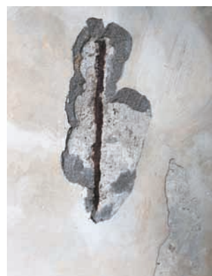
写真1 PCa造の現場打ち基礎部分のかぶり厚さ不足によるコンクリートのはく落
