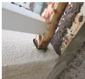
写真3 バルコニー一部の鉄製手すり(接合部)の劣化
