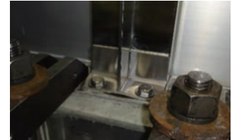
写真8 損傷状況 ・中柱脚部補強リブの変形
