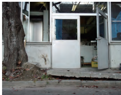
写真5 根の肥大により持ち上げられたコンクリートスラブ
