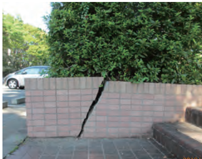
写真2 植物の根で割られてしまった擁壁
