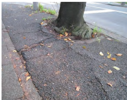
写真4 根により持ち上げられたアスファルト舗装の歩道
