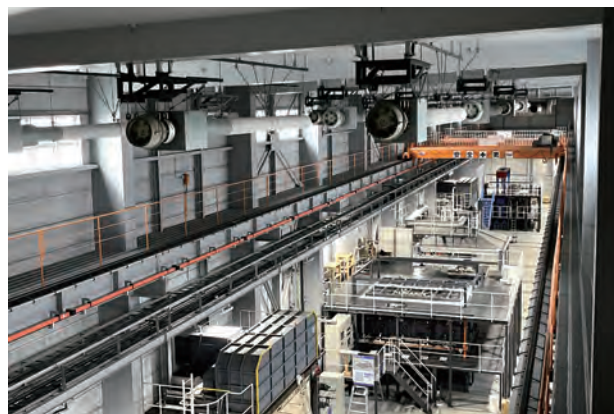
写真12 天井排煙処理装置
