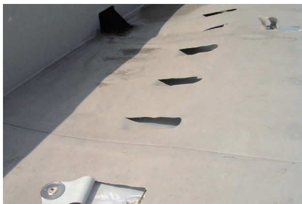
写真2 台風による防水層の破損
