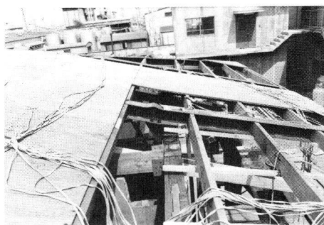
写真-4 母屋受材の破壊状況 (実大家屋)
