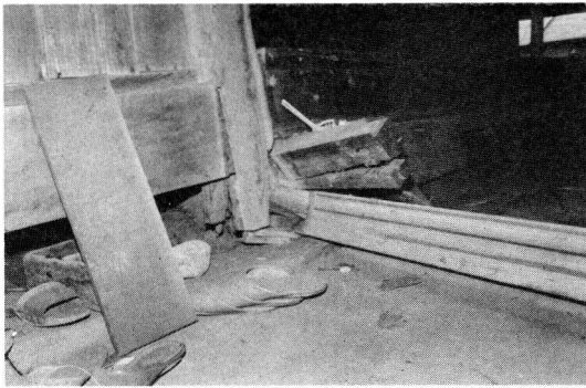
写真-17 調査番号29 柱脚の破壊状況
