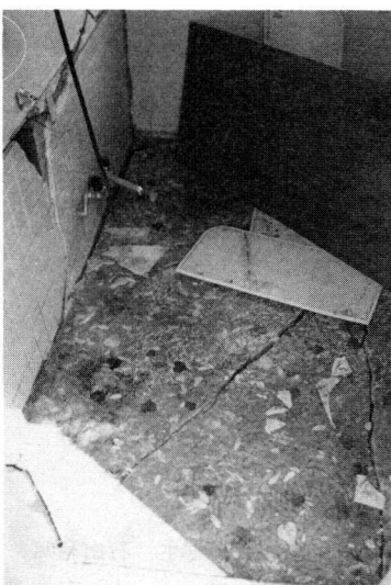
写真-14 調査番号22 風呂場の破壊状況
