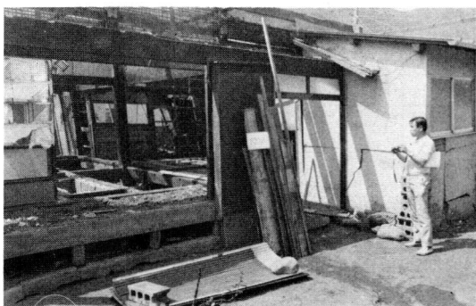
写真-3 木造家屋の破壊状況
