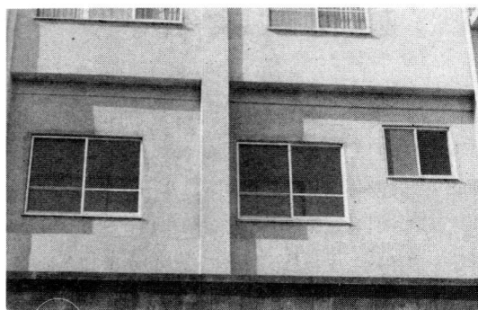
写真-22 調査番号19 RC造の破損状況
