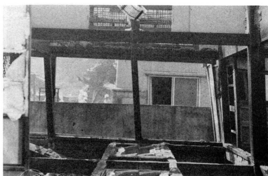
写真-11 調査番号22 軸組のせん断変形
