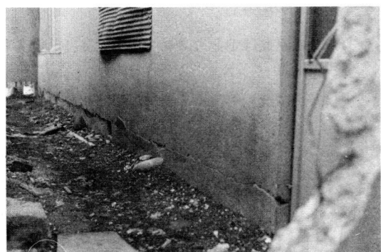
写真-23 調査番号14 基礎と土台のずれ
