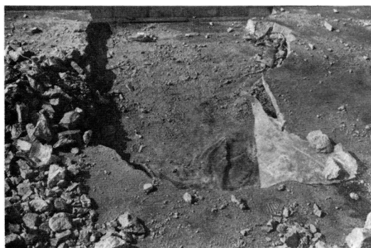
写真-8 防水シートの破れ
