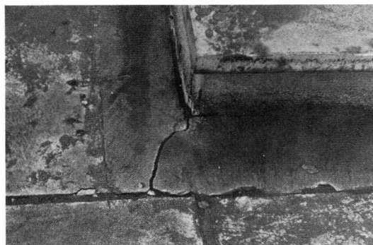
写真-11 排気筒部分のクラック
