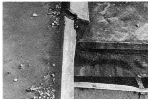
写真-13 押えモルタル打継ぎ部分のズレ
