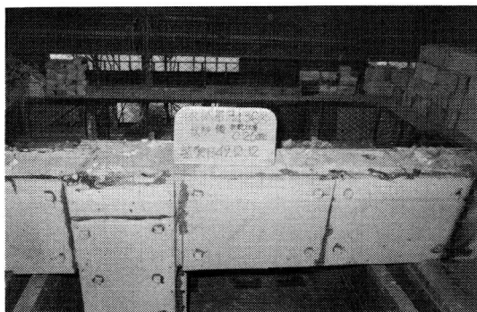
写真-3 試験後の梁部 (石綿けい酸カルシウム板の気乾比重0.20の面)
