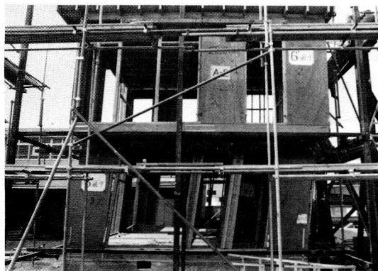
写真-14 破壊状況 全景 試験体記号 A-2
