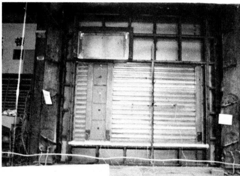
写真-2 加熱前の加熱裏面（屋内側）
