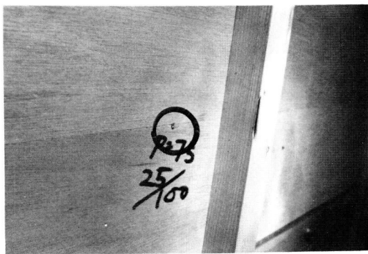
写真-3 漏水状況 平均圧力差 75 \text{ kgf/m}^2 (屋根勾配 25/100 )
