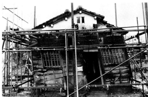
写真-1 破壊状況（全景）
