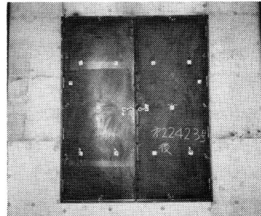
写真-4 加熱後の試験体裏面の状況
