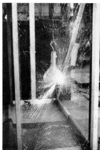
写真-2 フィルム張りガラスの破壊状況
