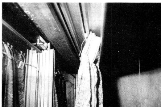
写真-4 カーテンボックスによるカーテンの取付状態
