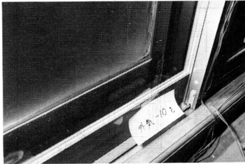
写真-7 外サッシ外障子下部召し合わせ付近内観 (内サッシ障子ガラスの結露水をふき取って観察 した外気 - 10℃)
