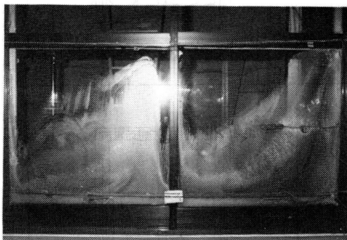
写真-12 外サッシ下部外観 (外気 - 15℃)
