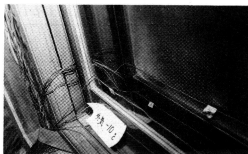
写真-6 外サッシ外障子下部戸当り付近内観 （内サッシ障子ガラスの結露水をふき取って観察 した外気-10℃）
