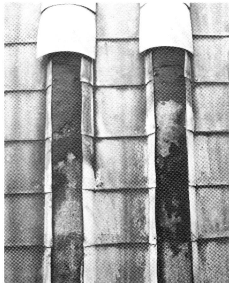
屋根下地の露出箇所
