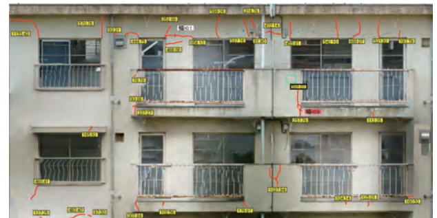
図6 ドローンで撮影した建物壁面の2次元モデルにひび割れ位置・長さ・幅を記入
