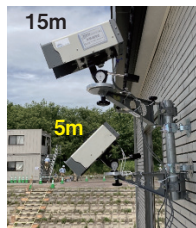
写真2 ドップラー式流速計設置
