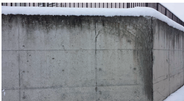
凍害（ひび割れ）の例
