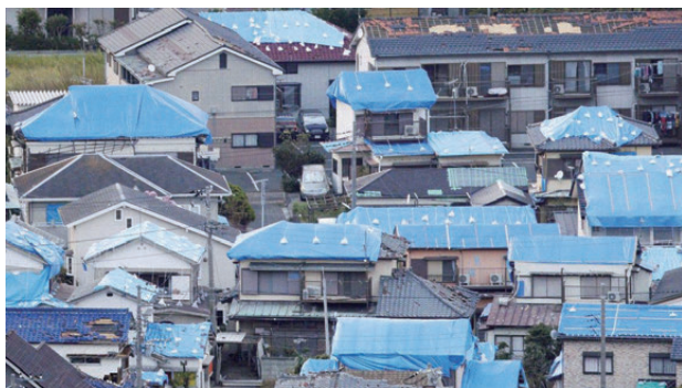
写真1 大型台風の後、ブルーシートで覆われた屋根
