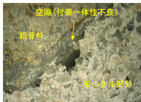
写真2 粗骨材とモルタルとの隙間（例）
