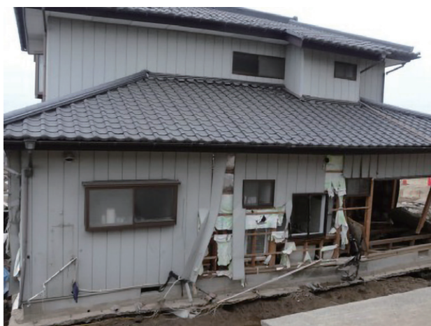
写真3 住宅の外壁の脱落
