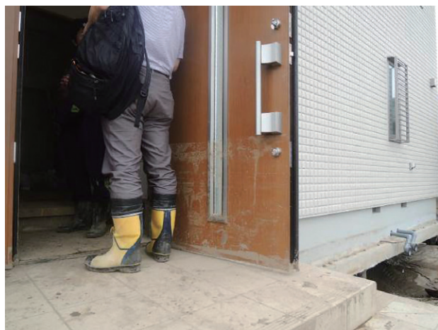
写真1 玄関ドアでの浸水の痕跡
