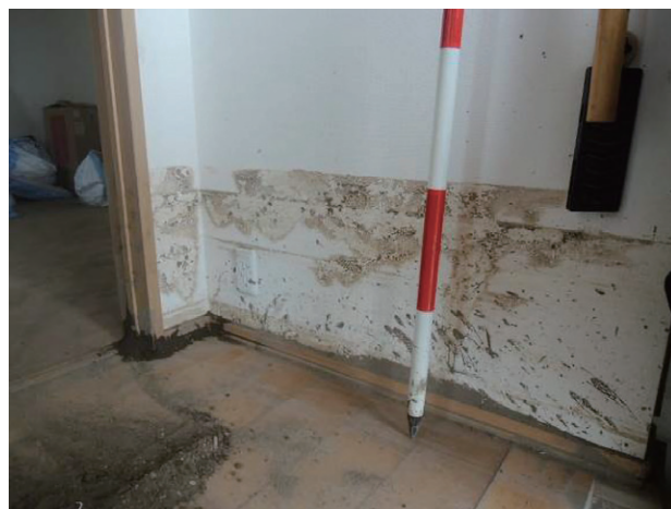
写真2 住宅内部での浸水の痕跡
